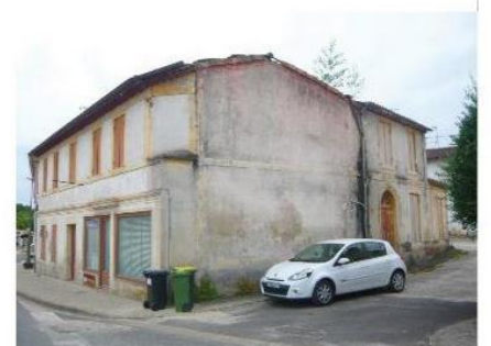
Immeuble vacant en état de ruine, côté rue du Centre
